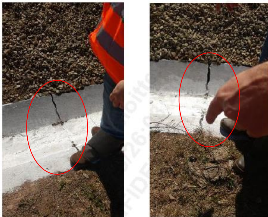
Foto 5 – Canaletas trincadas na região do maciço na ombreira esquerda – EL. 937 m.
