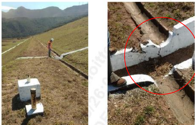
Foto 9 – Canal trincado – Elevação 905 m.
