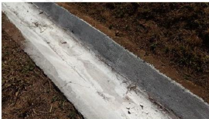
Foto 6 – Canaletas trincadas na região do maciço na ombreira esquerda – EL. 929,5 m.
