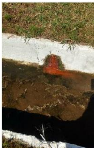
Foto 13 – Presença de colóide na saída do dreno interno que desagua no canal da segunda trincheira (da ombreira direita para esquerda) na bermã na EL. 899 m.
