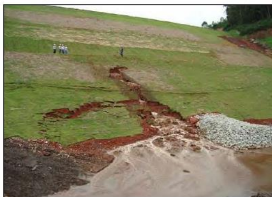
Figura 2-6 Efeitos da erosão interna no talude de jusante do Dique 1
