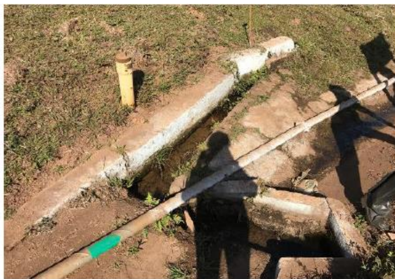
Foto 15 – Surgência de água sob dispositivo de drenagem no contato do maciço com a ombreira direita.
