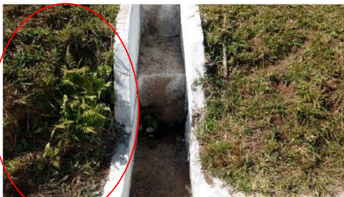
Foto 11 – Inclinação da parede da descida d'água na terceira trincheira (da ombreira direita para esquerda) na berma na EL. 899 m.
