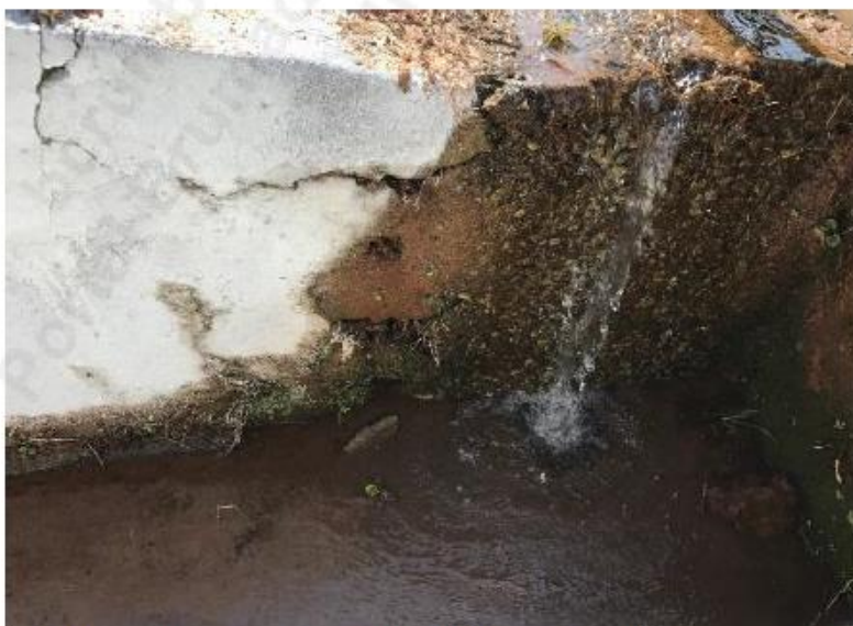
Foto 18 - Solapamento no início da descida d'água em escada, na berma da EL. 872 m.
