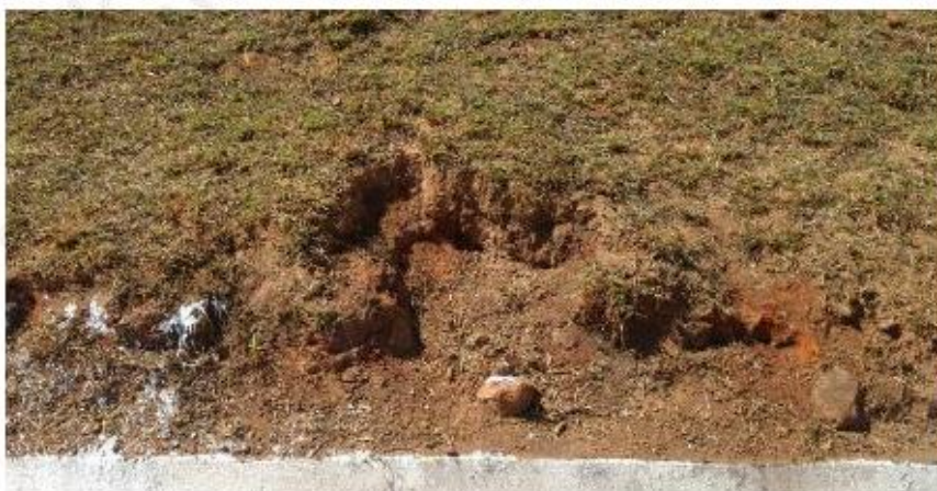
Foto 8 - Pequeno foco erosivo na El. 922,5 m.
