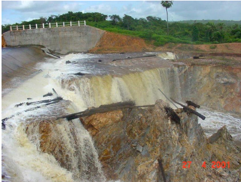
Figura 23: Outro exemplo de situação de emergência em barragem.
