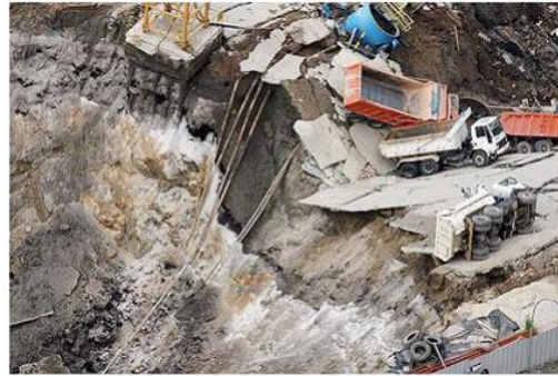
Licença ambiental renovada em dezembro de 2006: Não tratou de riscos de desabamento
