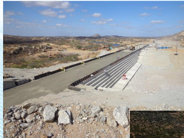
Barramento principal em CCR
