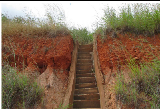
Figura 13 – Detalhamento da escada hidráulica da foto anterior, ineficaz para o direcionamento do fluxo de águas pluviais
