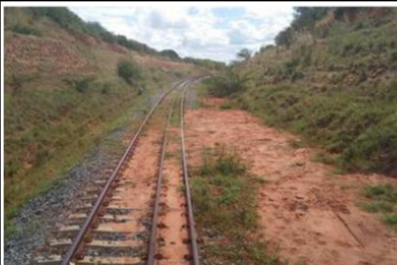
Figura 11 – Falha do projeto de drenagem (foto de junho de 2015)
