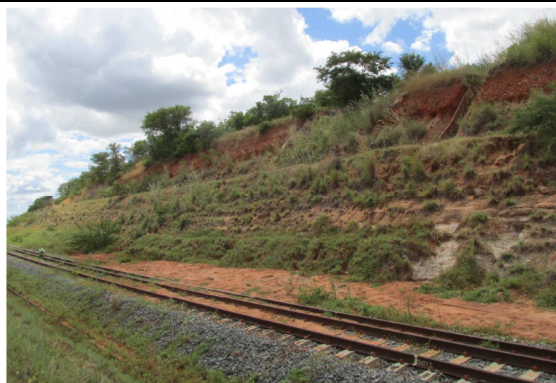
Figura 12 – Falha do projeto de drenagem, corte em talude com solo exposto
