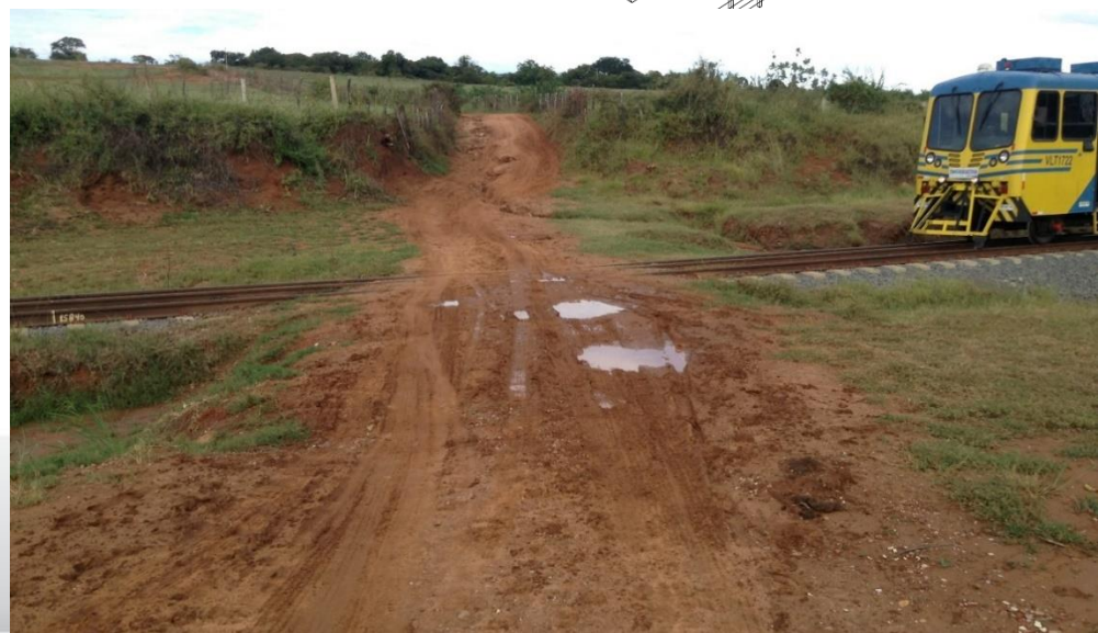
Passagem em nível não construída
