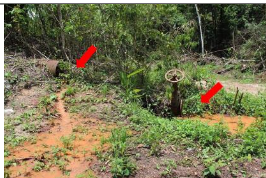
Figura 19 – Ponto de lançamento da tubulação irregular
