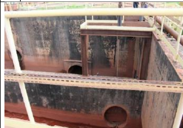
Figura 22 – Detalhe da comporta existente entre os dois compartimentos da caixa, que pode permitir a mistura dos efluentes.
