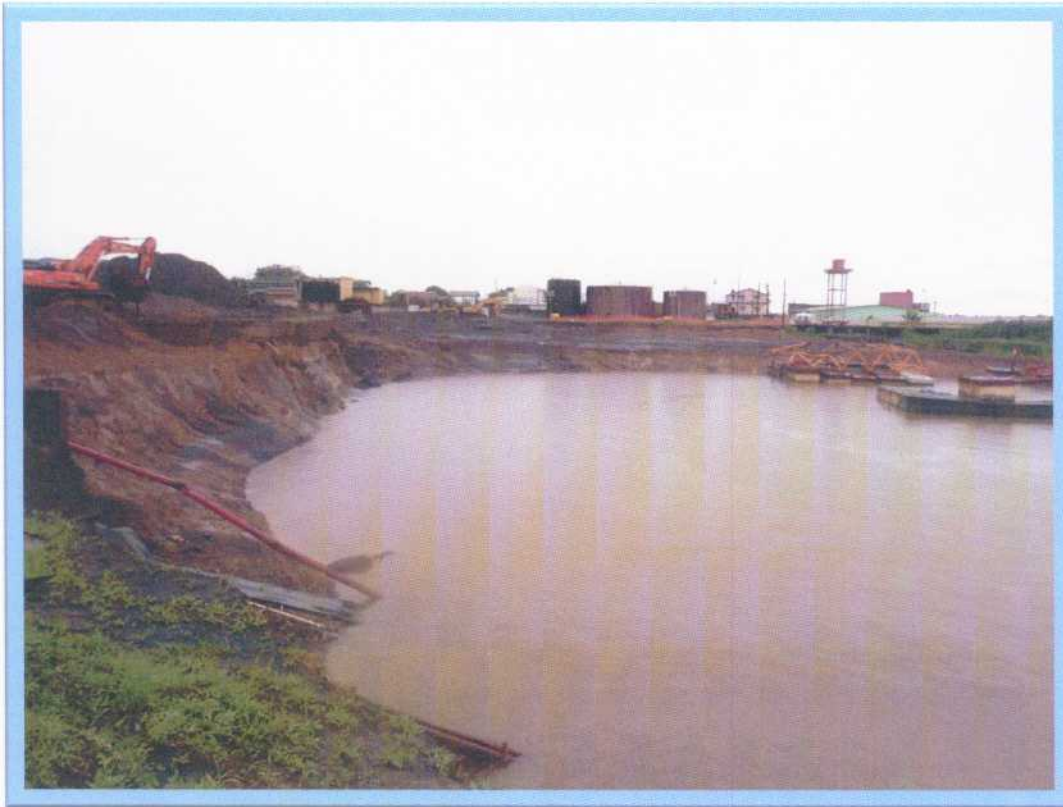
Figura 10: Área do porto de embarque de minério de ferro que sofreu deslizamento de terra. Notar a geometria circular da ruptura do aterro. Ao fundo parte da estrutura do píer flutuante. (21/04/2013)
