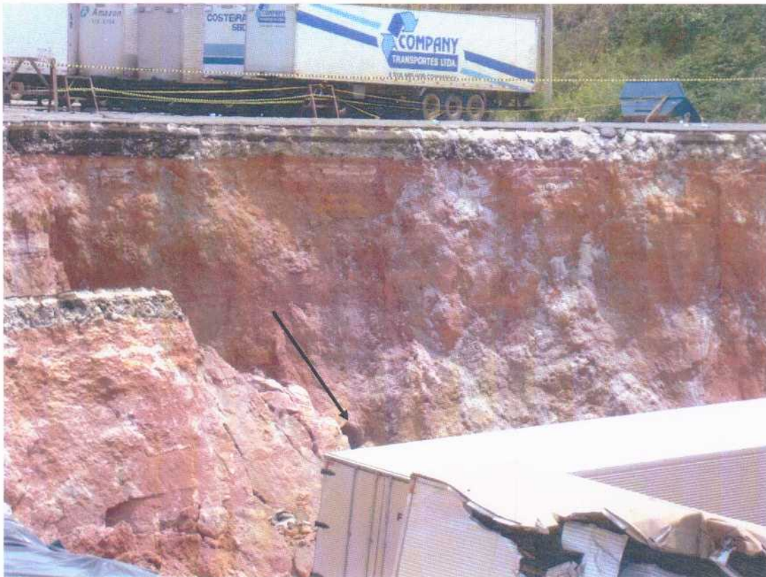
Figura 03: Superfície de ruptura mostrando o aterro e parte do sistema de drenagem (tubo de cimento indicado pela seta).
