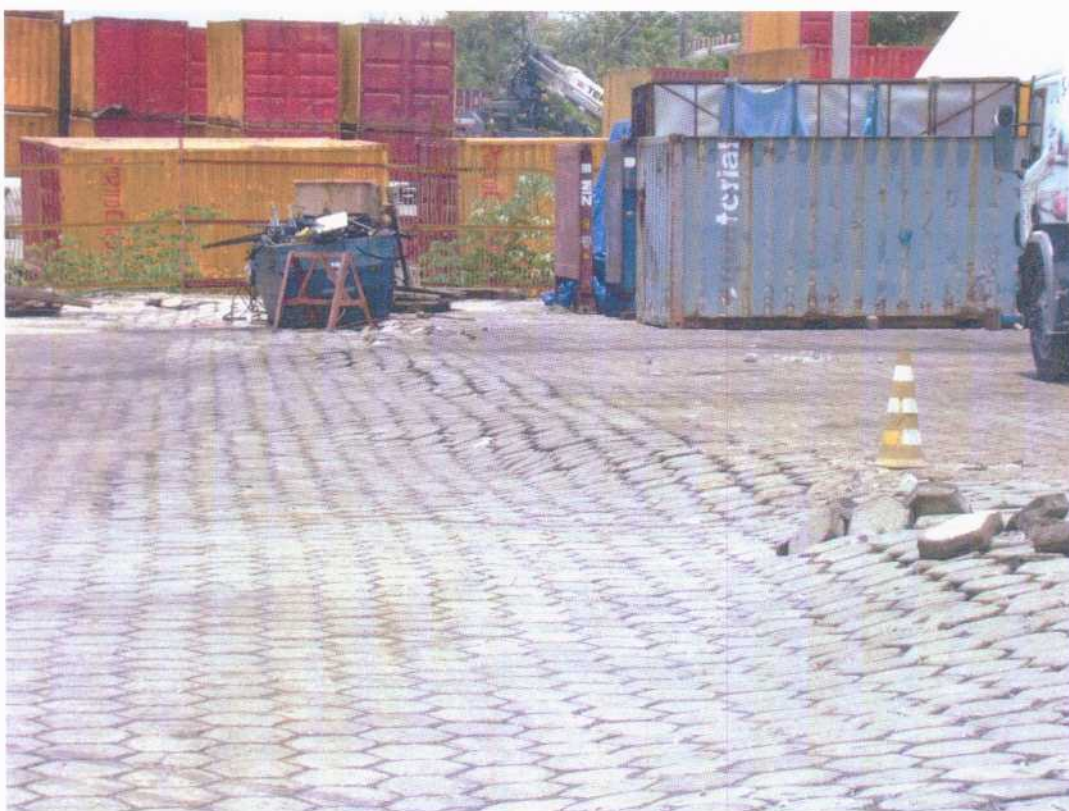
Figura 05: Afundamento do piso do pátio de contêineres do cais flutuante ao longo trinca de tração.
