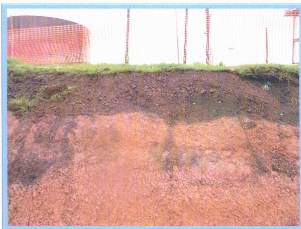
Figura 05: Aterro com camada de minério de manganês no topo e laterita na base.
