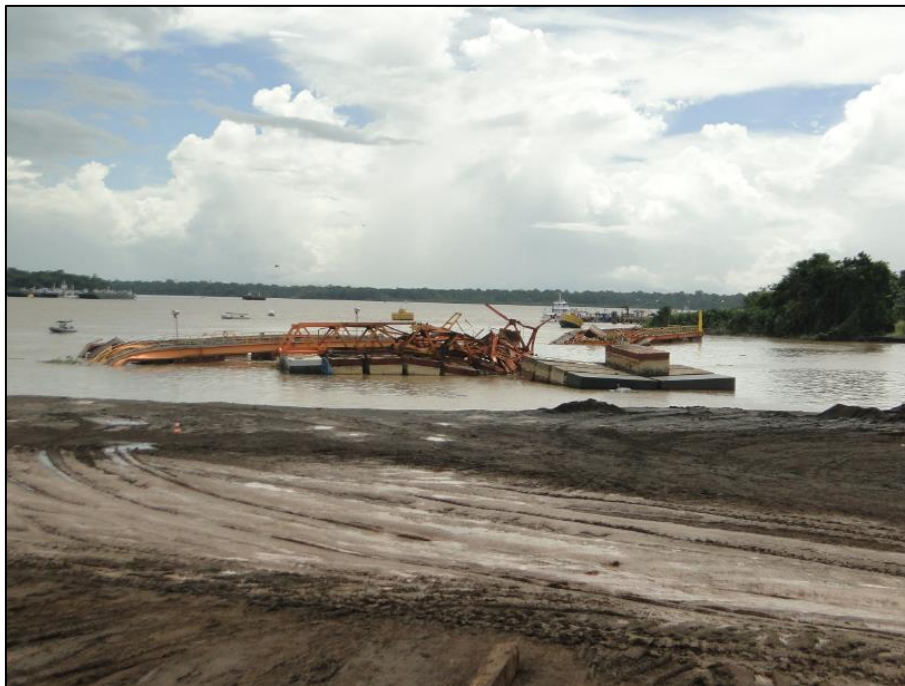
Figura 72 – Imagem 5 do Relatório – Ilustra a estrutura do Porto parcialmente submersa, marcas de pneus na margem do rio, evidenciando tráfego de veículo dessa região e bem como, depósitos de minérios encontrados próximos da margem do rio Amazonas.
