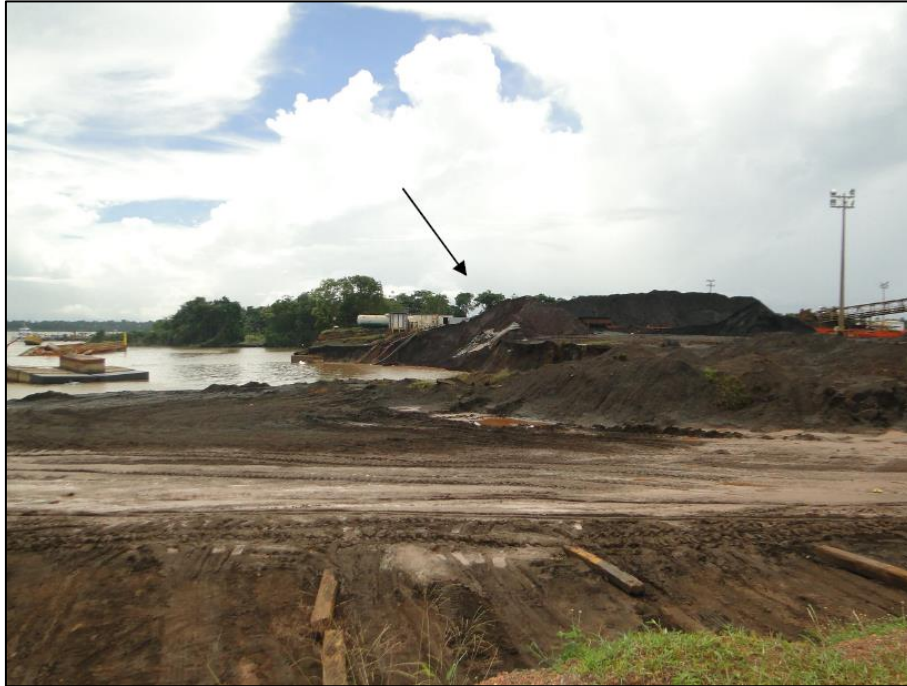
Figura 73 – Imagem 06 do Relatório – Ilustra a estrutura do Porto parcialmente submersa, marcas de pneus na margem do rio, evidenciando tráfego de veículo dessa região e bem como, depósitos de minérios encontrados próximos da margem do rio Amazonas.
