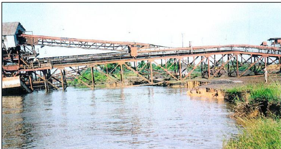
Figura 46 – Outro ângulo do mesmo local, mostrando a crista do talude após o deslizamento.
