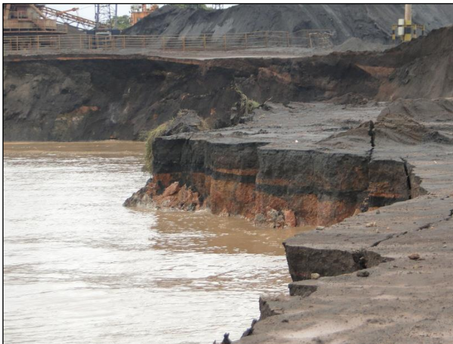
Figura 74 – Imagem 7 do Relatório – Mostra uma camada de minério assentado sobre a camada de solo natural e linhas ou fendas de rupturas na área periciada.
