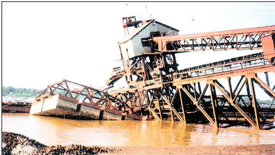
Figura 48 – Aspecto geral do dano provocado na estrutura flutuante que suportava o carregador de navios.
