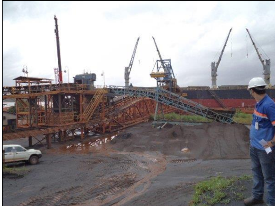
Figura 37 – Carregador móvel montado próximo à torre de amostragem, no lado oeste.
