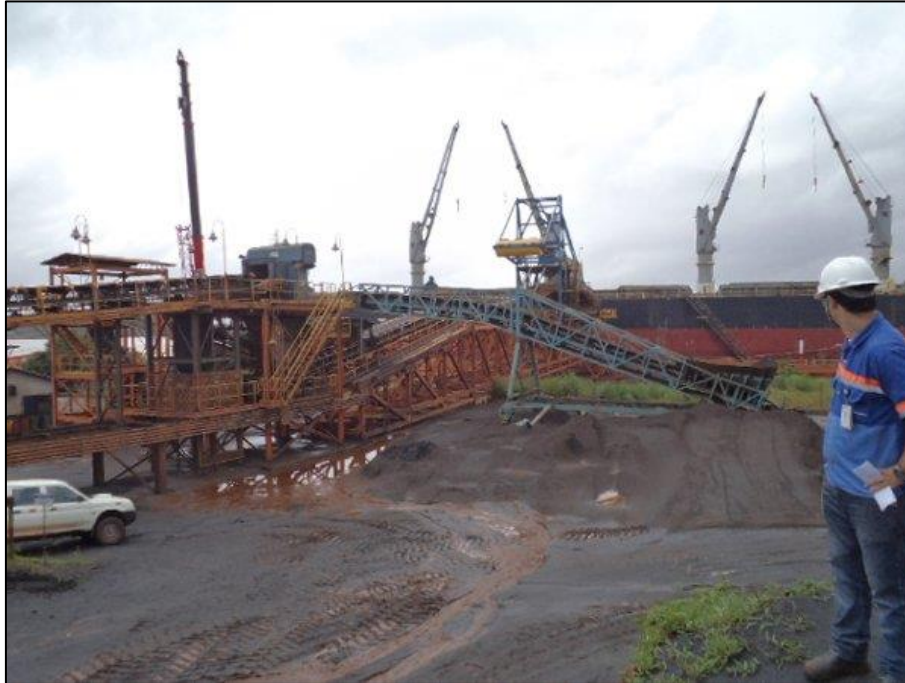
Figura 83 – Foto tirada em fevereiro de 2013, após a avaria da retomadora. Carregamento feito do lado oeste, a partir de um transportador móvel.
