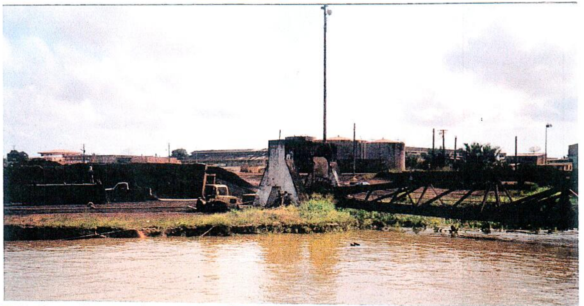
FOTO 2 - No canto esquerdo da foto observa-se a crista do talude desmoronado na região da ancoragem do "a frame" 1.
