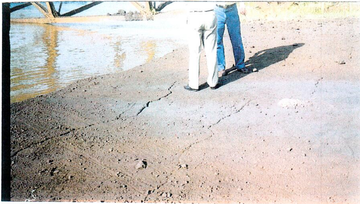
FOTO 5 - Trincas de tração na crista do talude deslizado.
