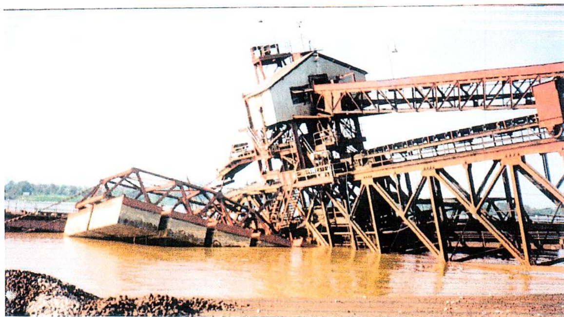
FOTO 6 - Aspecto geral do dano provocado no flutuante do carregador de navios pelo deslizamento de terra.
