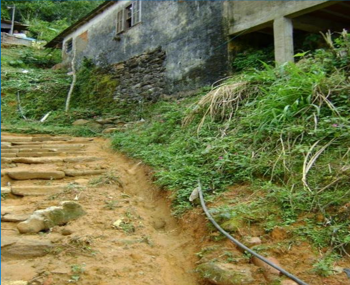
Pequena canaleta feita pelos moradores para escoar a água que desce a encosta em dias de chuva intensa. F. S. Lima.
