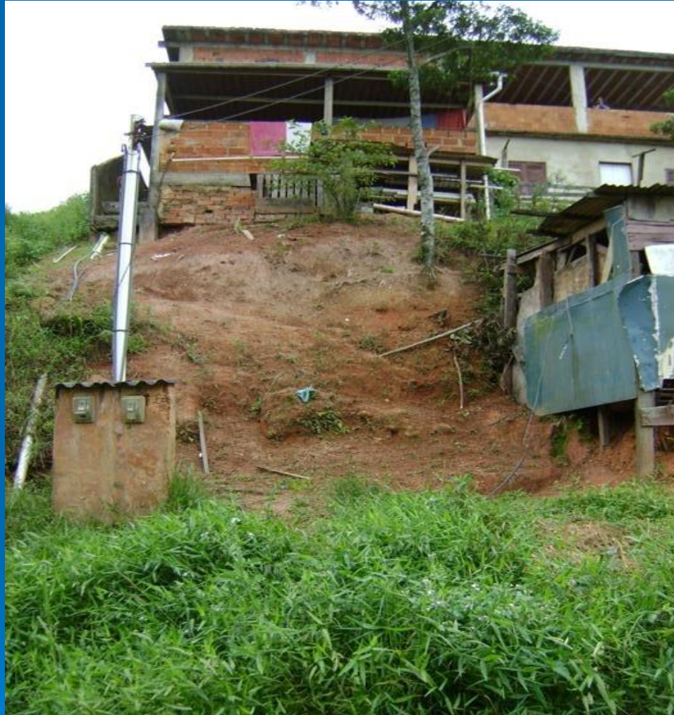
Aspecto estrutural de casa na parte de cima da rua. Foto E. S. Lima.
