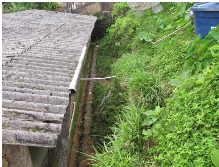
Figura 9. Exemplo de corte de talude muito estreito para instalação da casa.
