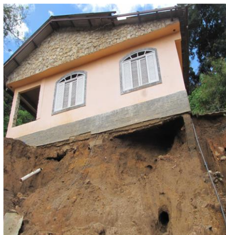
Figura 7. Deslizamento no Bairro Quitandinha, em março de 2013.
