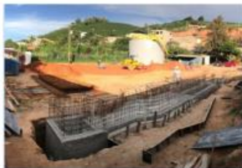
ETE (Tratamento Preliminar)
