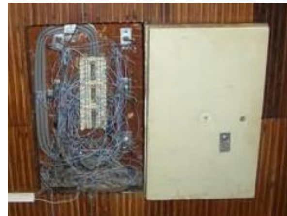
Quadro de distribuição nos andares.
