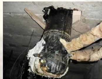
Vazamento na caixa sifonada
