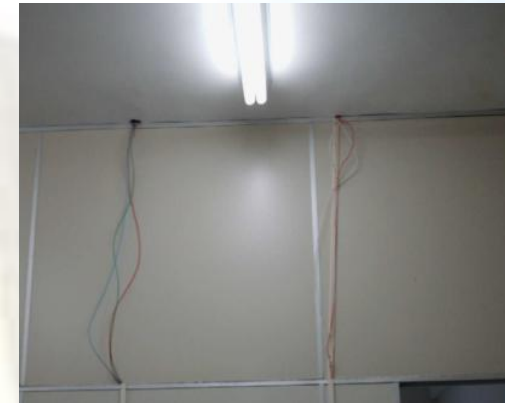
Instalações elétricas inadequadas.
