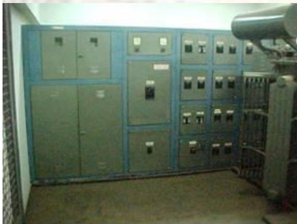
Vista geral do painel e transformador.
