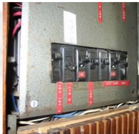
Detalhe dos disjuntores antigos
