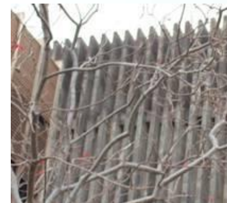
Pergolado frontal: concreto desgastado
