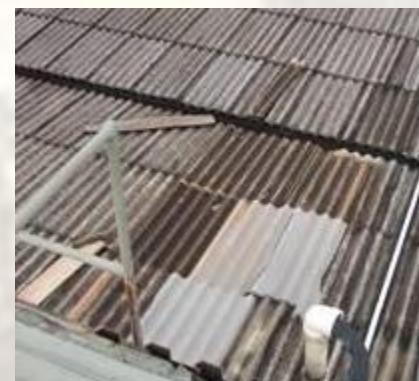
Telhas velhas e improvisadas.
