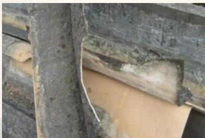
Telhas quebradas – ponto de infiltrações
