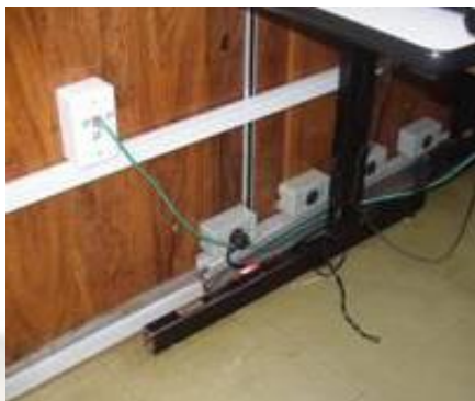
Uso excessivo de canaletas plásticas.
