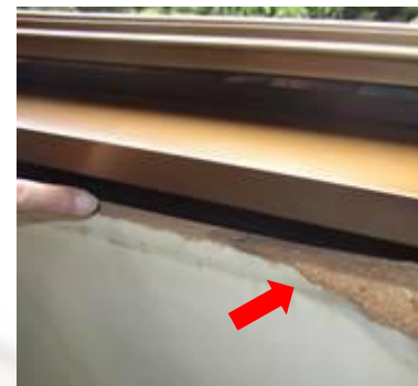
Apodrecimento do painel interno.
