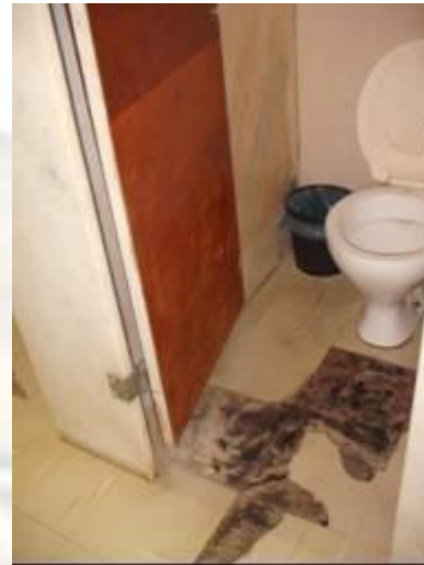
Piso WC feminino deteriorado pelos constantes vazamentos.
