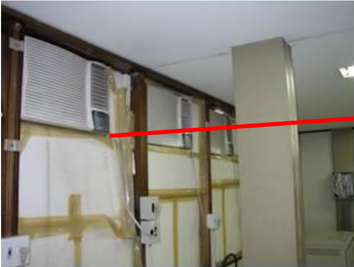
ACJ's : refrigeração da sala dos servidores
