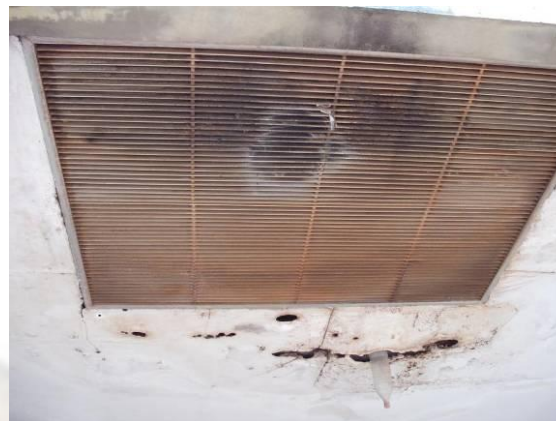
Grelha AP: corrosão e infiltração na laje
