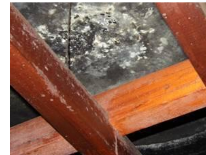
Infiltração na laje do subsolo -
