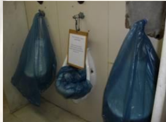
Mictórios interditados por vazamentos
