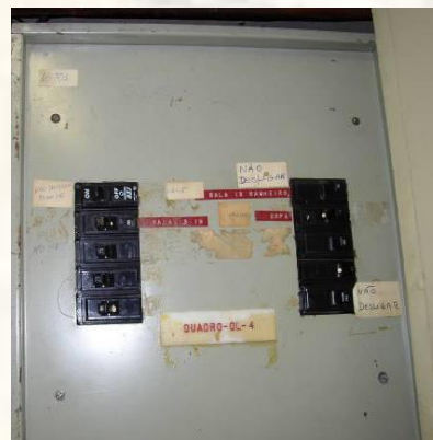
Detalhe do quadro de disjuntores (QGBT)
