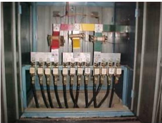
Cabos de entrada no disjuntor geral (DG)
