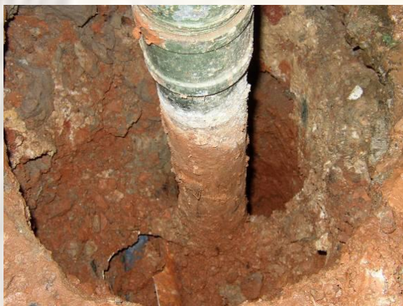
Detalhe: tubulação de sucção no subsolo.
