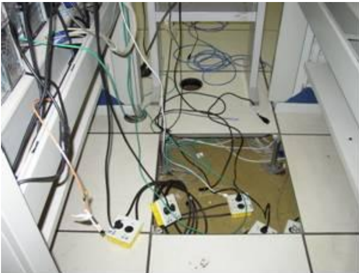
Cabos, fios e tomadas sob piso elevado
