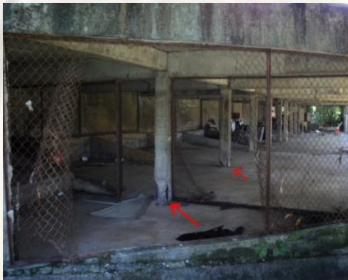
Exposição de armaduras em pilares
