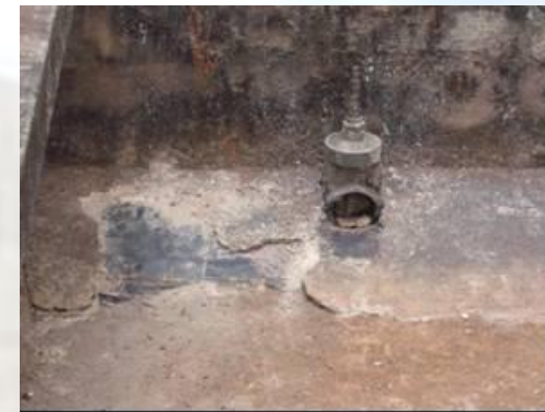
Desprendimento da proteção mecânica da impermeabilização da laje do espelho d'água.
