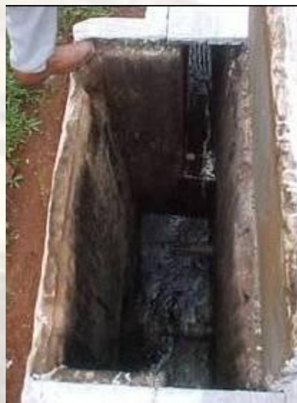
Canaleta: possibilidade de transbordamento.
