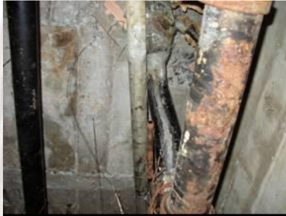
Corrosão avançada na tubulação ES
