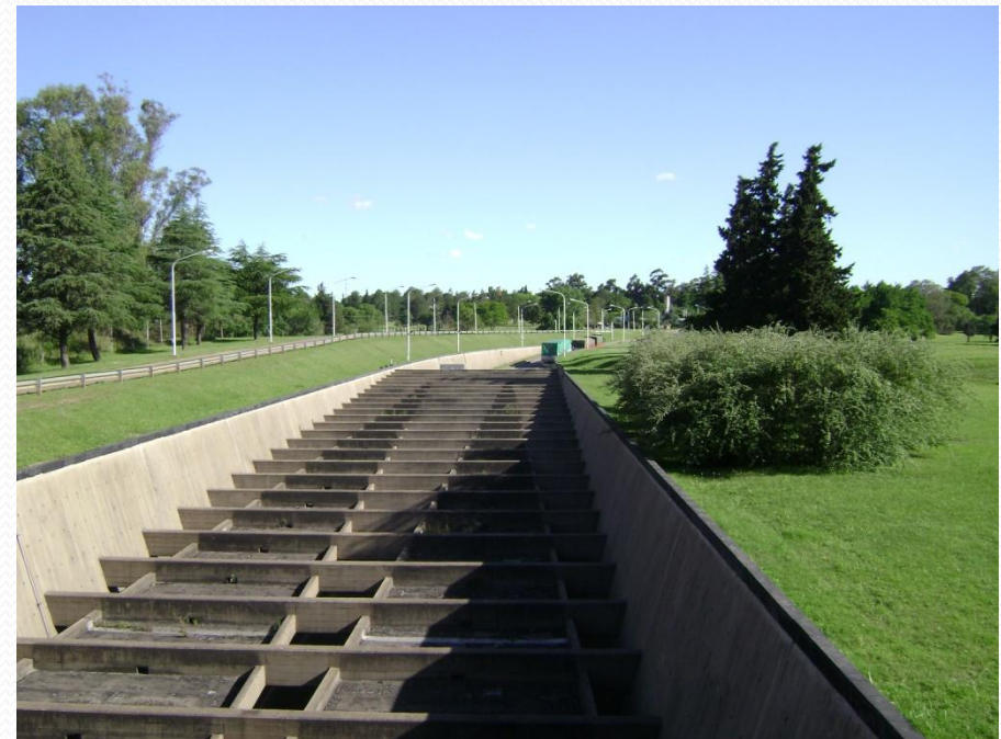
VENTILAÇÃO DO TÚNEL
