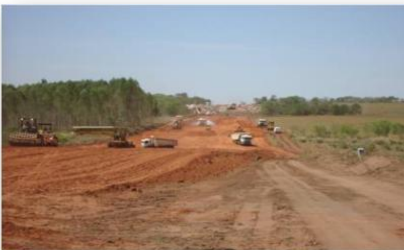
Monitoramento de Processo Erosivo
