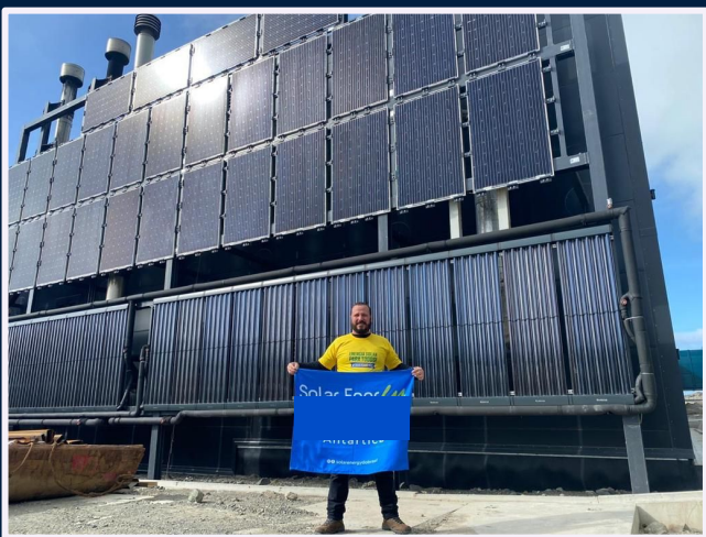
ESTAÇÃO COMANDANTE FERRAZ - ANTÁRTICA - Fomos recebidos pela Marinha do Brasil para comissionar a Usina solar instalada na Antártica.
