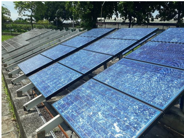
Ensaio de Sistemas fotovoltaicos domiciliares Eletrobras Cepel
