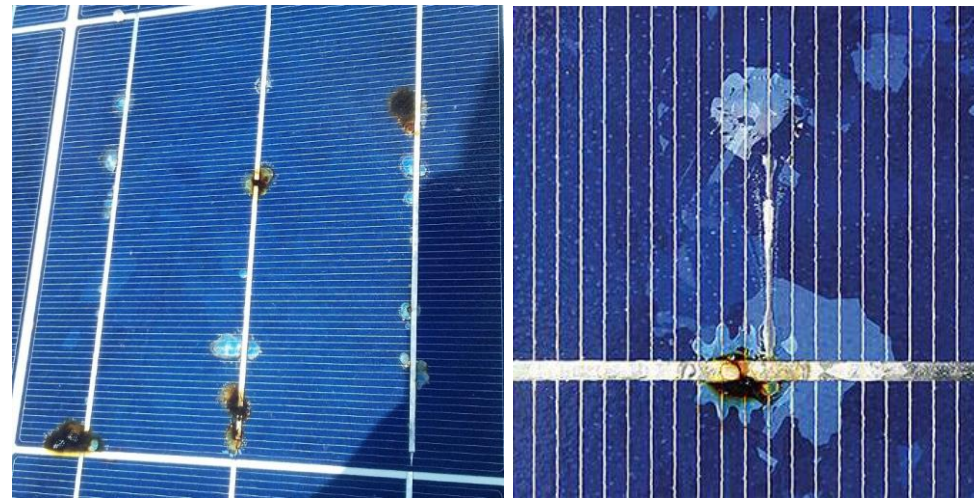
Falhas de Equipamentos
