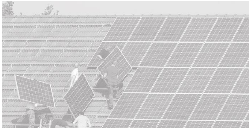
Falhas na Instalação / Execução do Projeto
