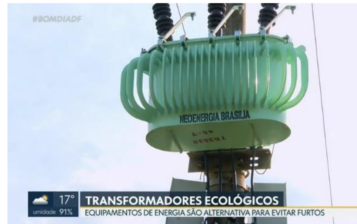
Transformadores ecológicos, como alternativa para furtos
