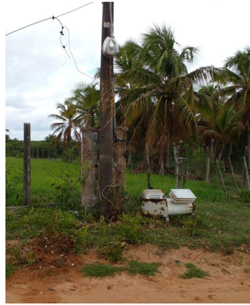
Bandidos derrubaram transformador e furtaram núcleo de cobre
