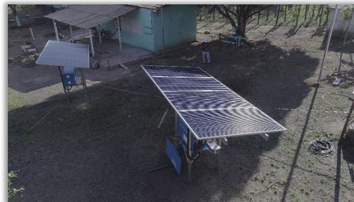
Foto: Equatorial Energia - Pará
