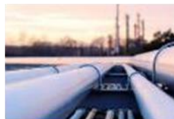
Pipelines (existentes e novos)
