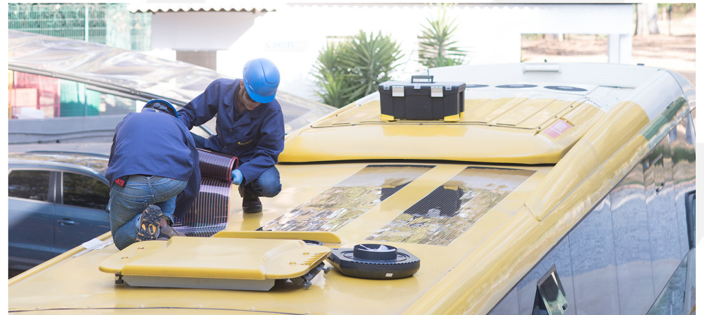
Módulos solares fotovoltaicos em ônibus intermunicipal, Belo Horizonte (MG).
