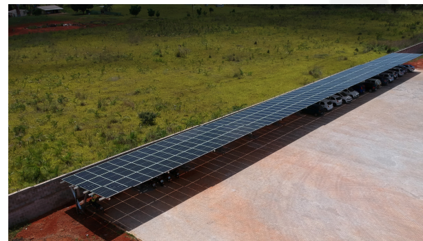
Cobertura de estacionamento de distribuidora de frutas, Santa Cruz do Sul (RS).
