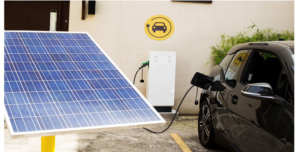
Estação de recarga solar fotovoltaica para veículos elétricos no Paraíso, São Paulo (SP).
