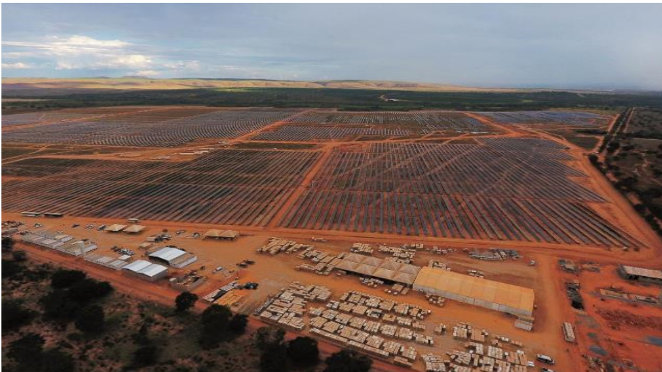
UFV de 185 MWp em Pirapora (MG).
