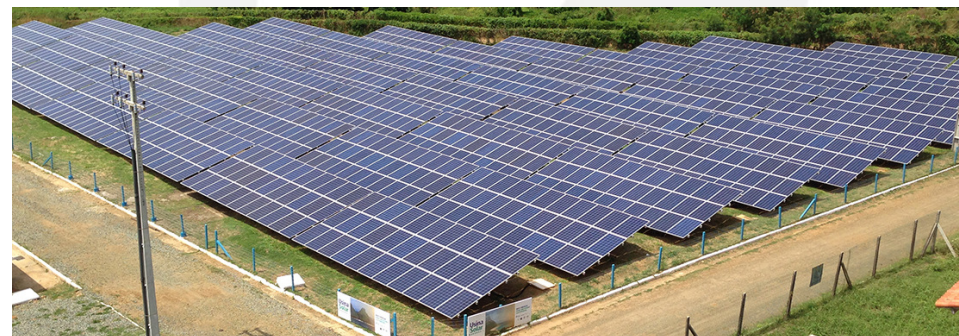
Usina solar fotovoltaica: Fernando de Noronha (PE).
