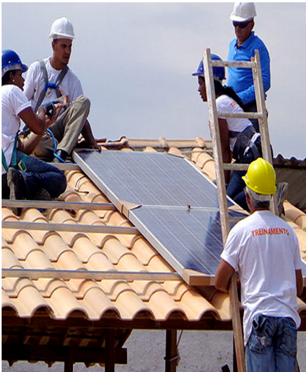
Telhados Solares, Juazeiro, BA
