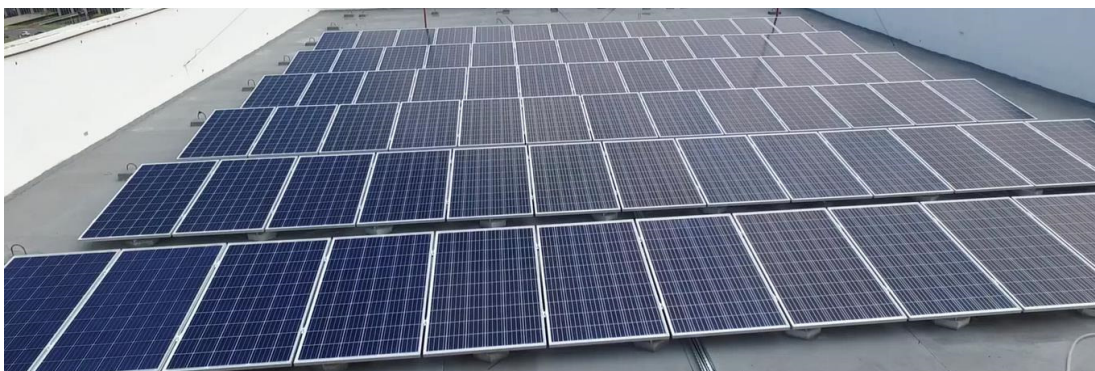
Imagens: Usina solar fotovoltaica no telhado do edifício-sede do Ministério de Minas e Energia, em Brasília (DF).
