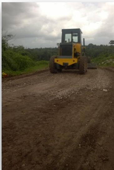
Rampa de subida dos coletores de lixo
