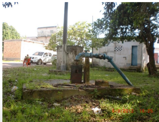
Estação de bombeamento de água Barcarena
