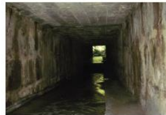
Sistema de drenagem foi adaptado e já é usado como passagem subterrânea para a travessia da pista por animais silvestres.
