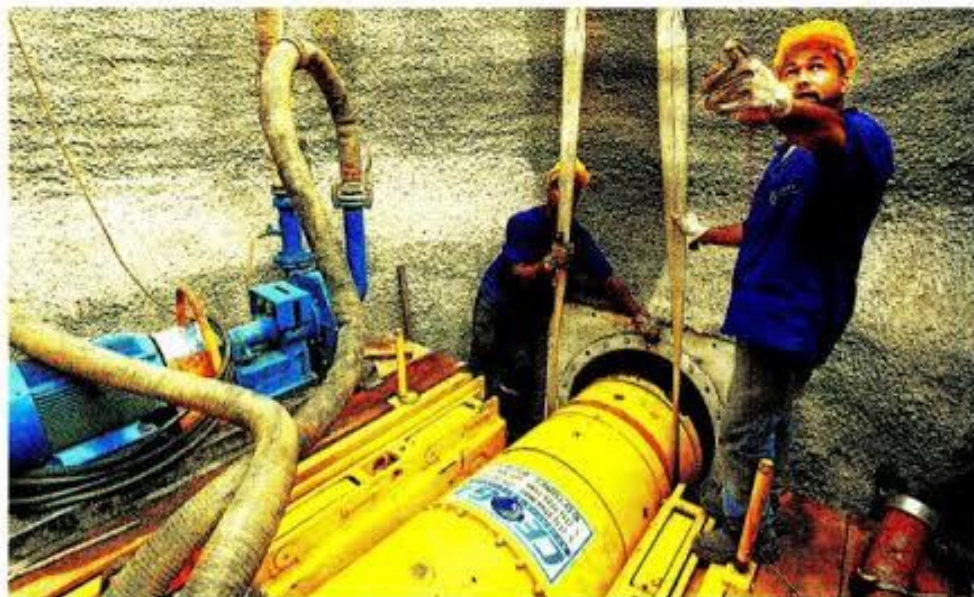
Em ação. Operários orientam o funcionamento do shield, que abrirá caminho de um quilômetro, entre o Centro e o bairro da Glória.
