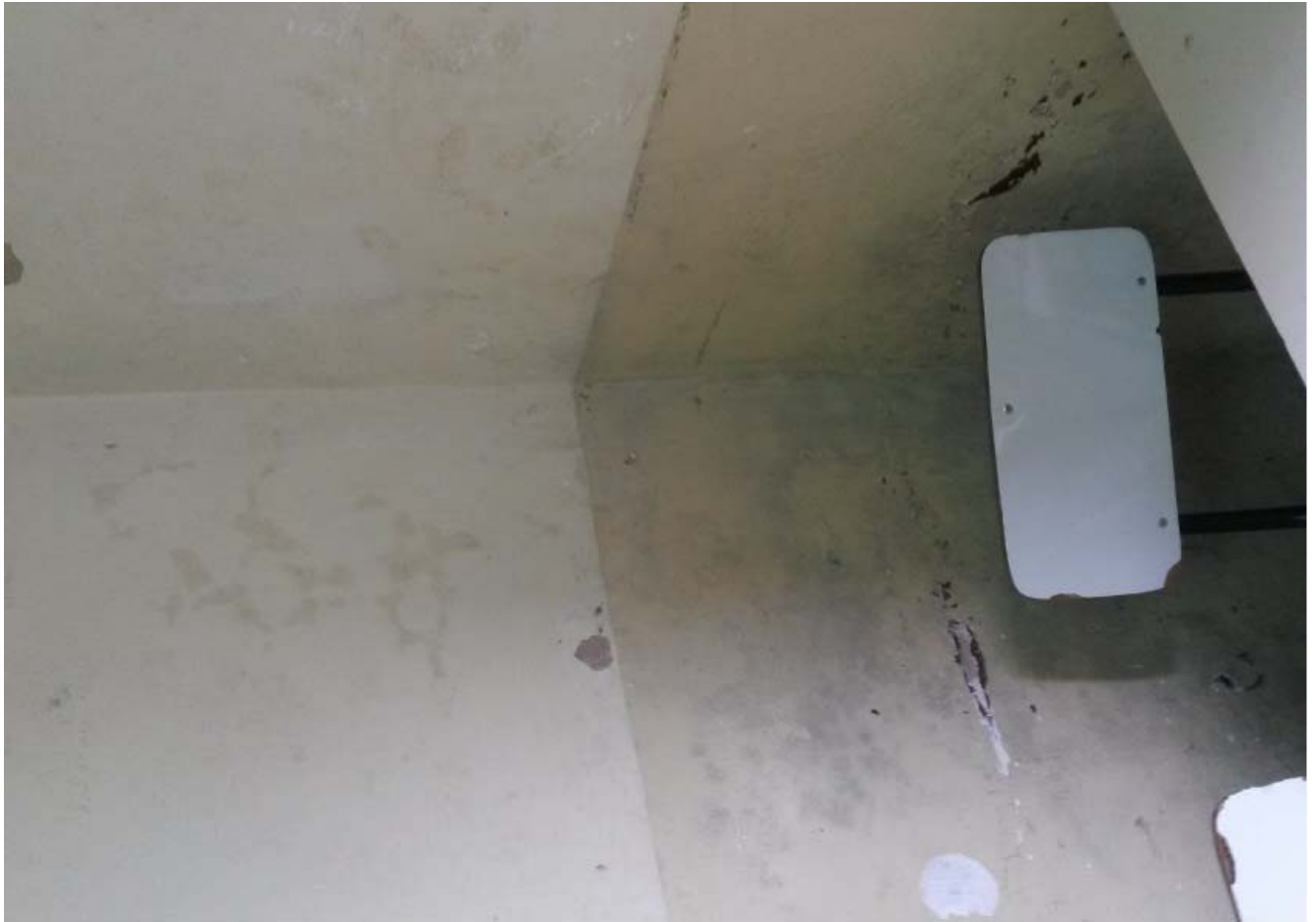
Destaque - Infiltração em sala de aula - CIEC Jaci Kobi Rodrigues - Alegre/ES
