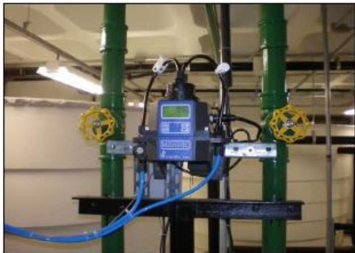
Figura 3 – Automação (Turbidímetro on-line)
