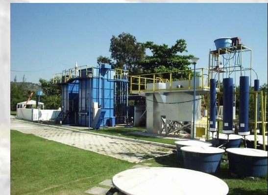
Estação experimental de tratamento de águas de abastecimento e residuárias e reuso de água - UFES
