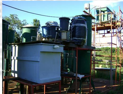
Estação experimental de tratamento de água por filtração em múltiplas etapas - UNESP
