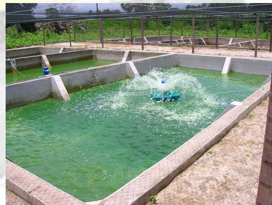
Estação experimental de tratamento de piscicultura utilizando efluente de ETE - UFC
