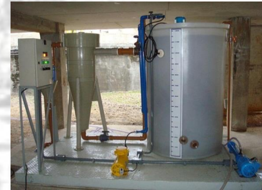
Estação experimental de tratamento de tratamento de lixiviado - UERJ/Águas de Niterói
