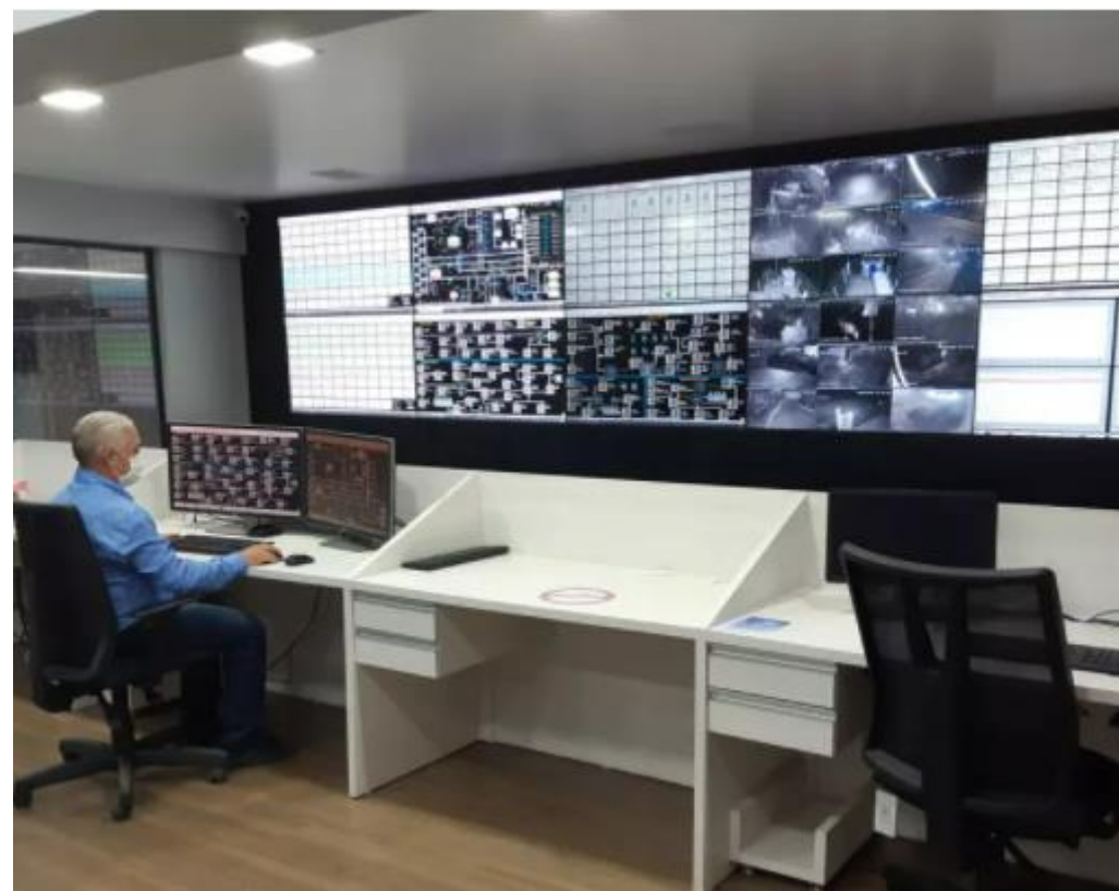
Centro de Controle Operacional da Prolagos recebe novas tecnologias. Região dos Lagos (Cabo Frio, Armação dos Búzios, Iguaba Grande, Arraial do Cabo e São Pedro da Aldeia)
