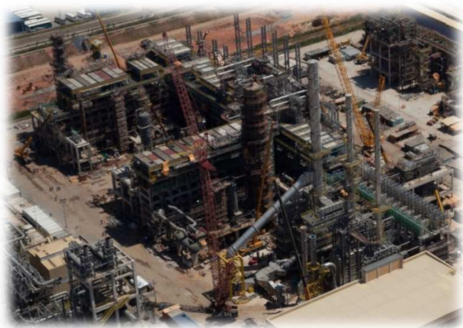
Unid. de Hidrocraqueamento
