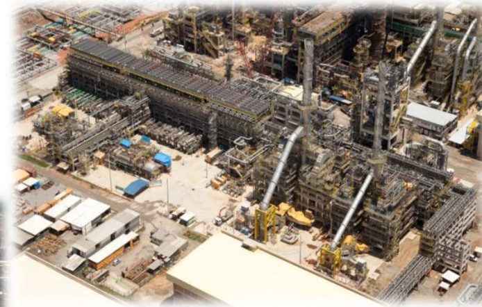
Unidade de Destilação Atmosférica e a Vácuo
