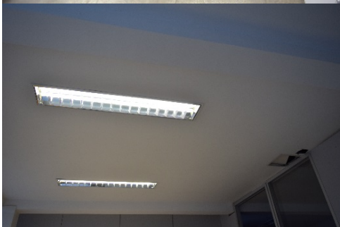
Iluminação fluorescente. Teto com forro, rebaixado.
