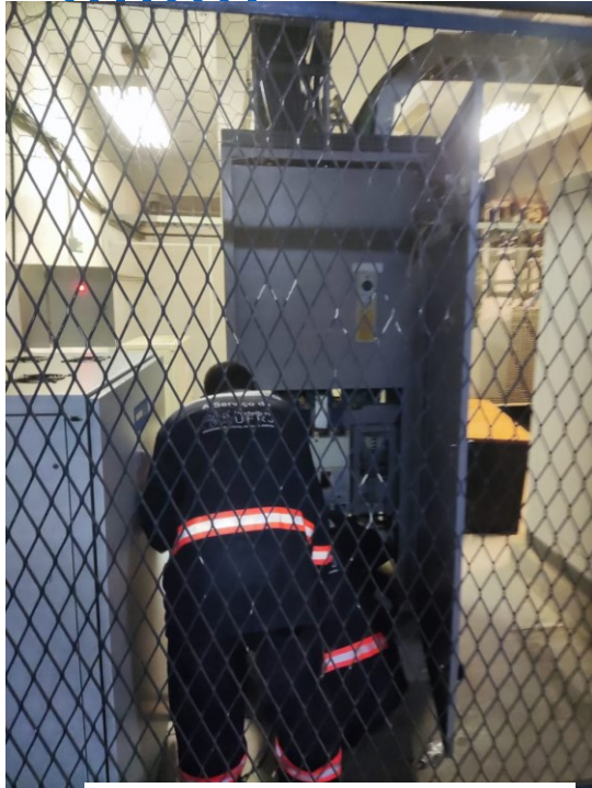
Quadro de Transferência Automático (QTA)
