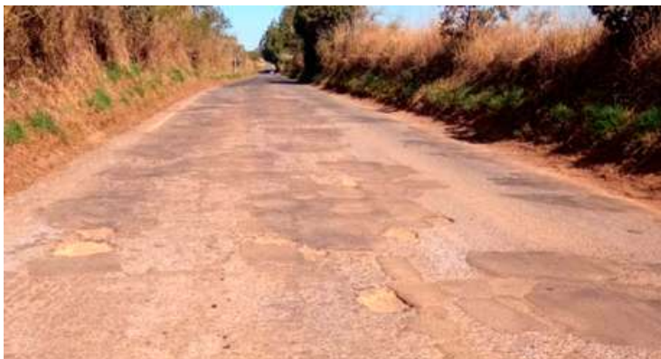
Algumas rodovias mineiras apresentam problemas de manutenção Foto: DER-MG
