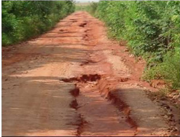
Erosão em estradas
