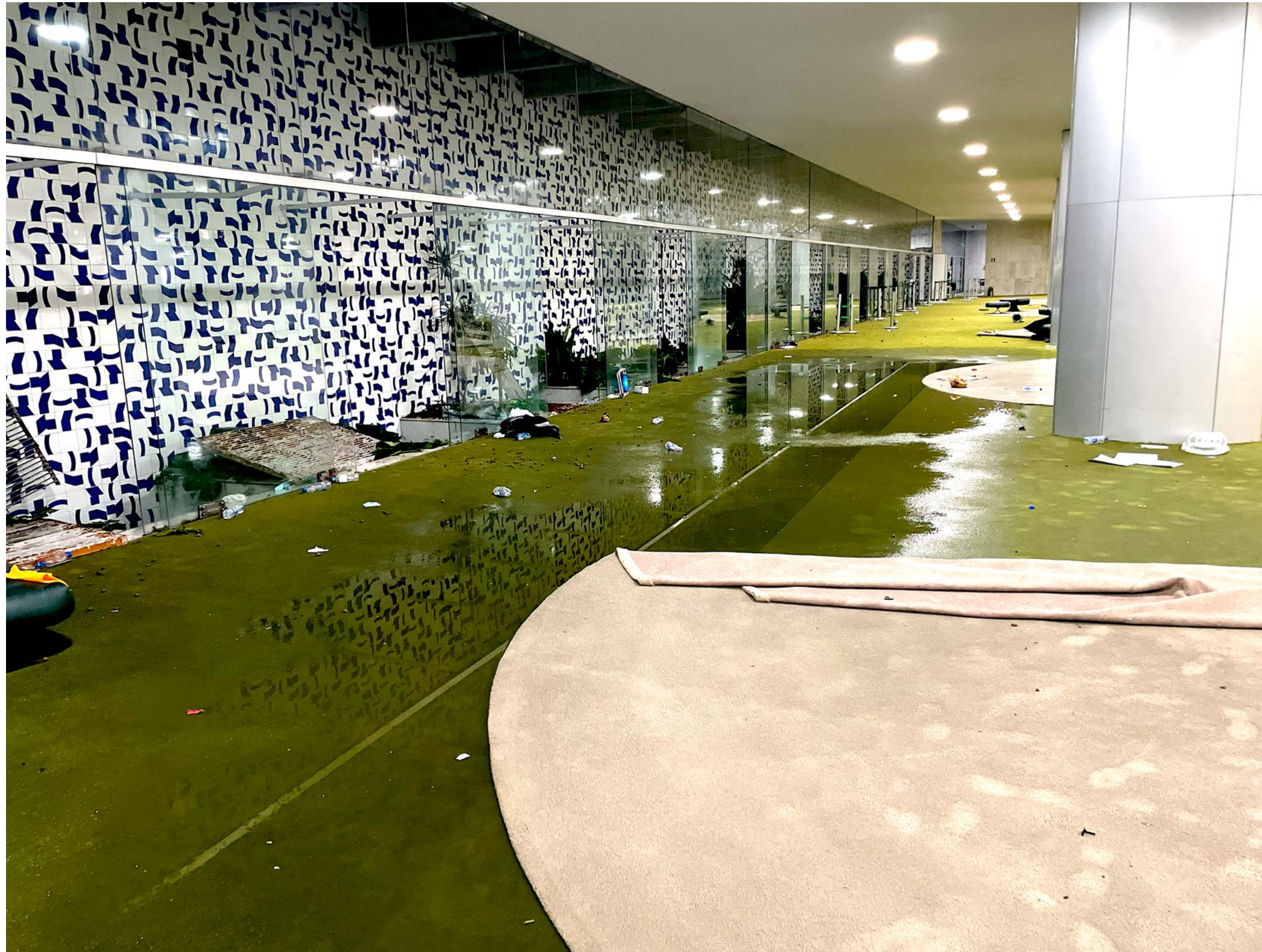
Salão Verde parcialmente alagado e com o jardim interno destruído. Foto: Clauder Diniz/Câmara.
