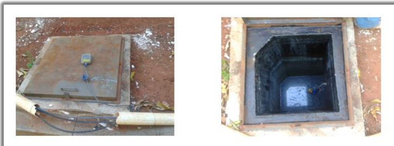
Figura 4: Reservatório de efluentes químicos perigosos
