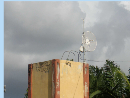
Antena Instalada na Escola
