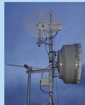
Antena Instalada no CTG-UFPE
