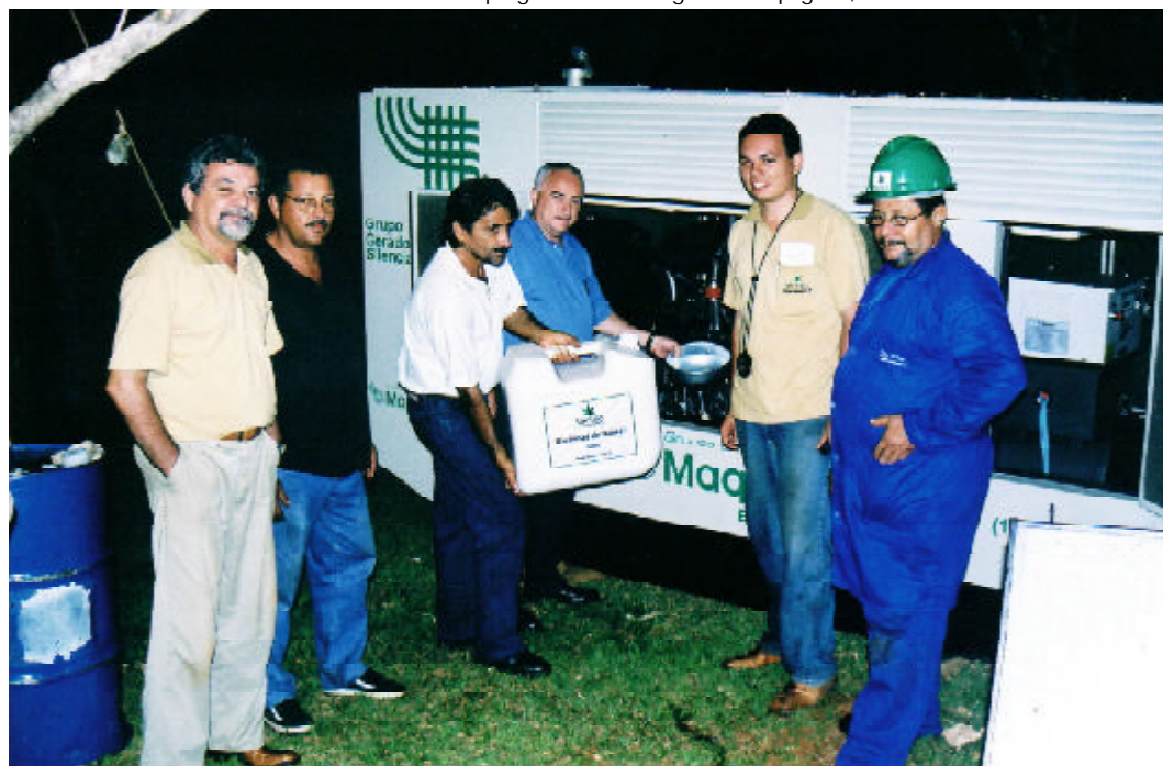
Grupo gerador de energia da Maquigeral, sendo abastecido com biodiesel
