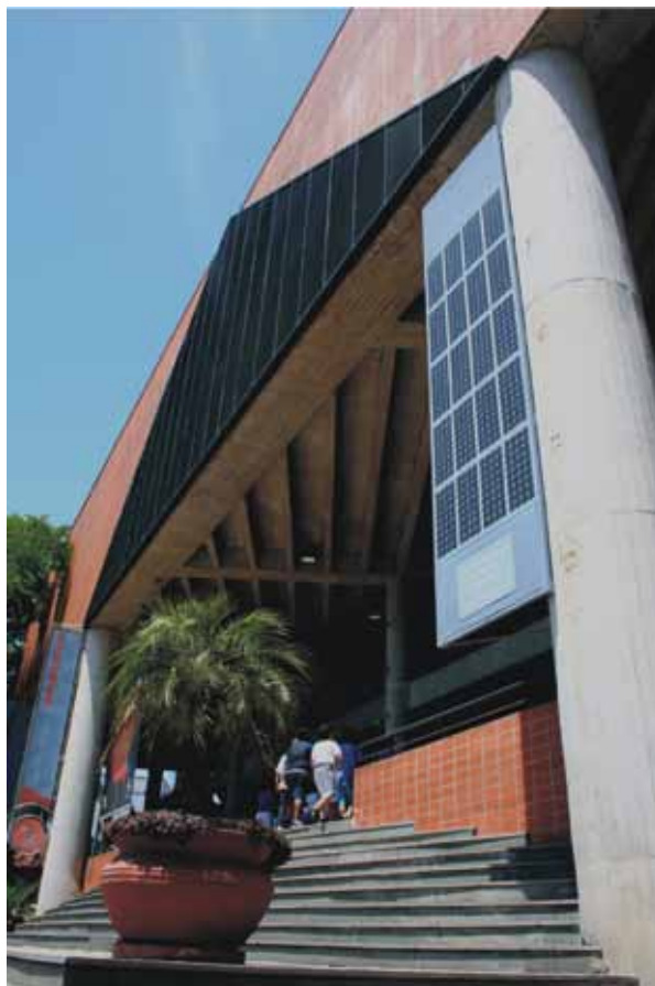
Figura 6. Sistema fotovoltaico interligado à rede elétrica e instalado na fachada do Museu de Ciências e Tecnologia da PUCRS. Tecnologia de fabricação nacional e com função educativa.
