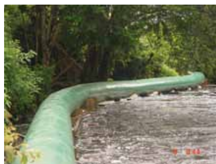
Conduto de baixa pressão
