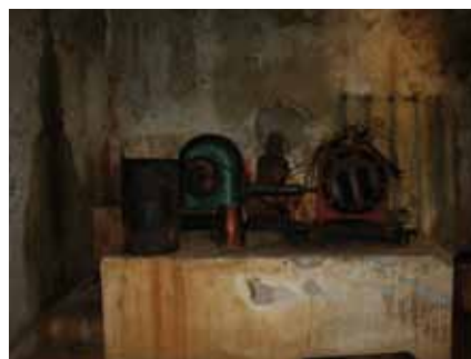
Grupos geradores novos com BFTs
